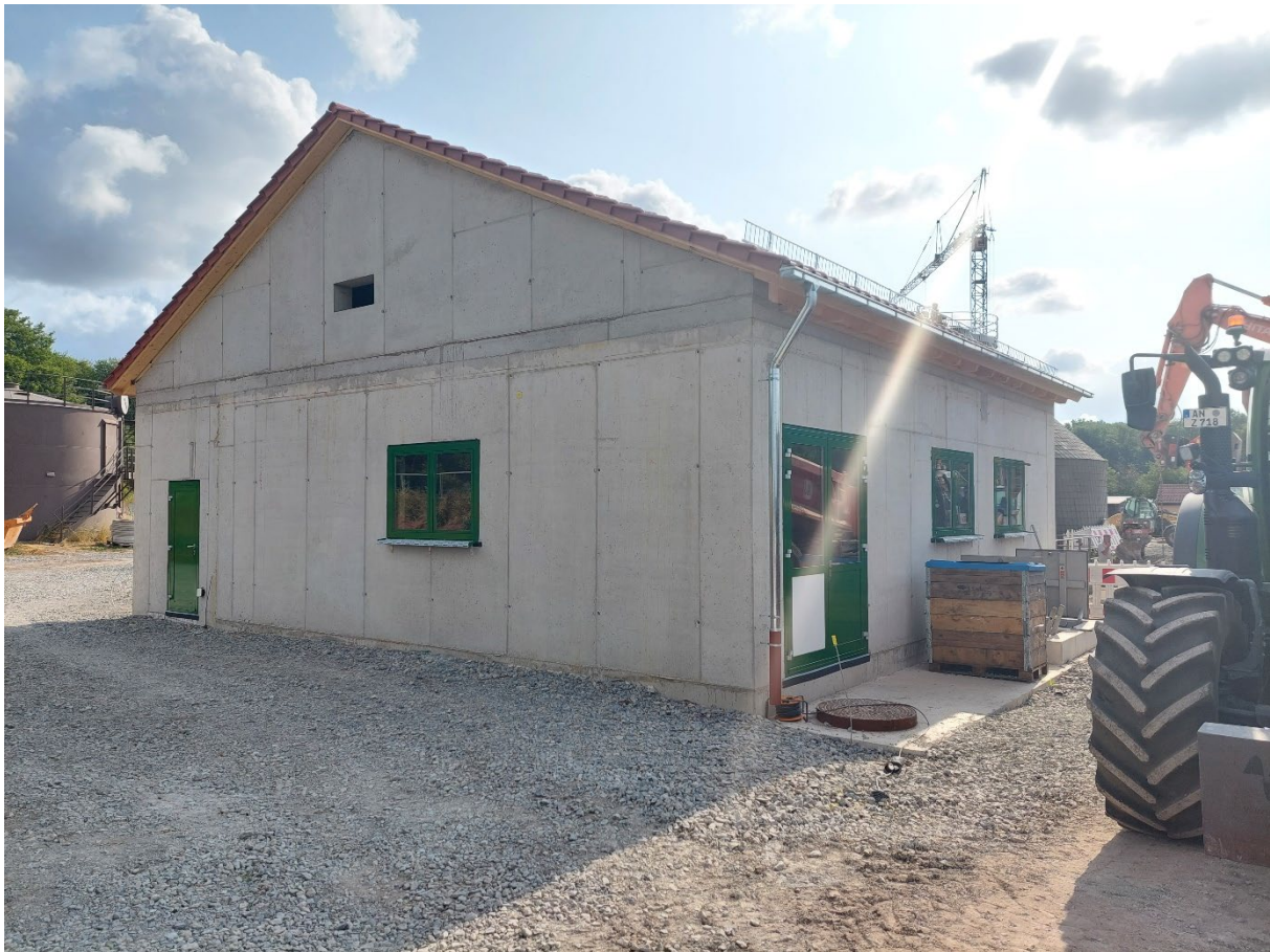
Das neue Maschinengebäude im Erdgeschoss mit Steuerungstechnik, Elektrik und Gebläsen; im Kellergeschoss finden Schlamm- und Abwasserpumpen Raum
