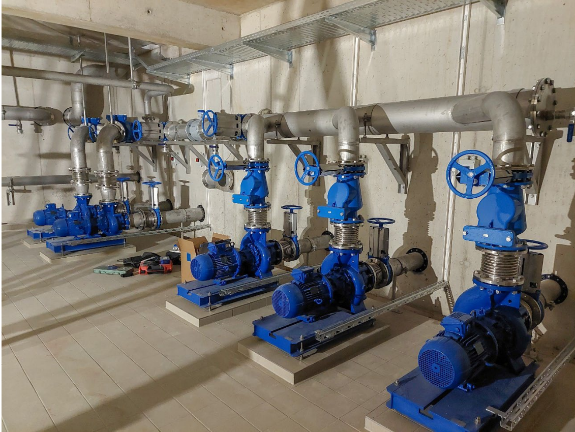
Neu installierte Abwasserpumpen im Keller des Maschinengebäudes
