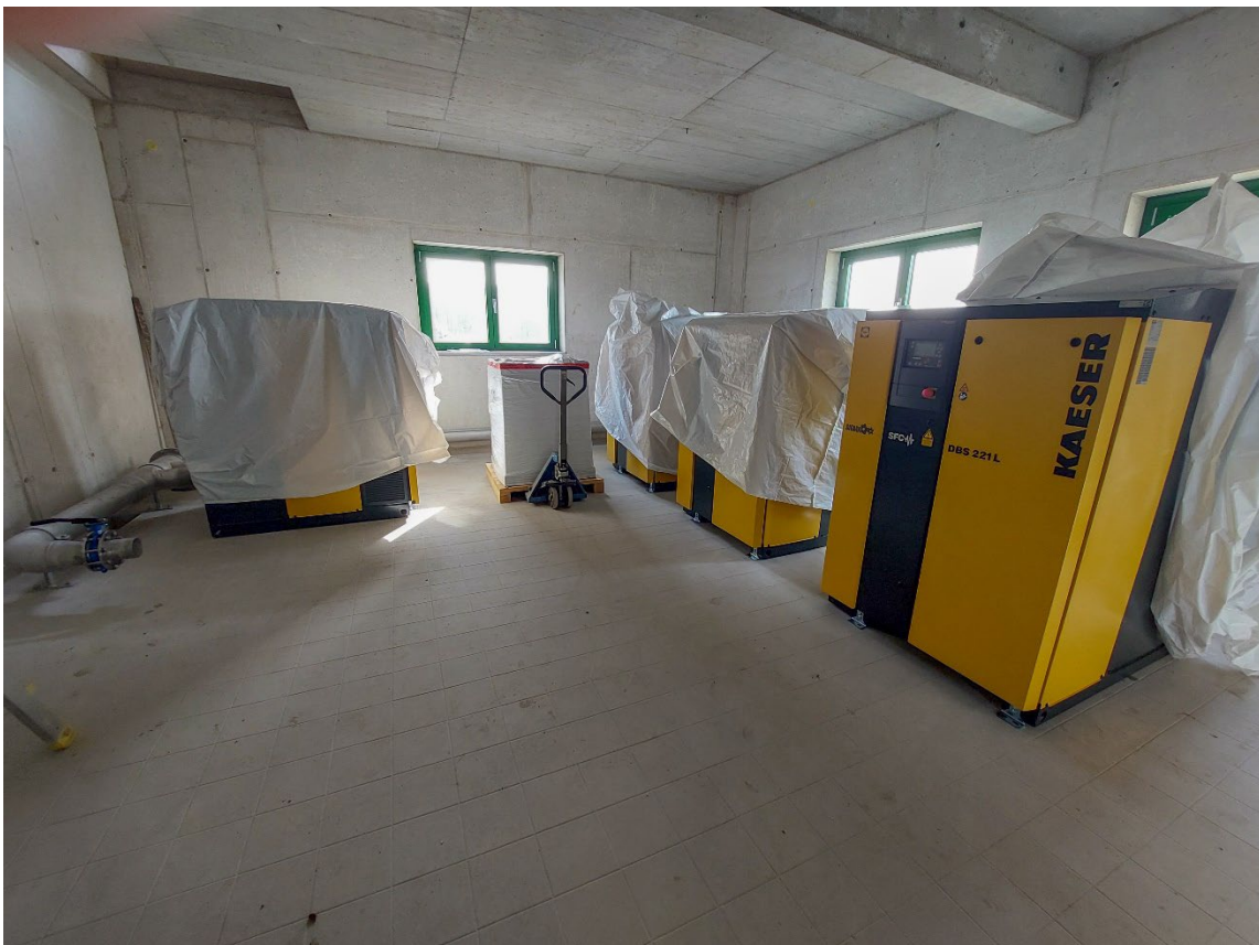
Kompressoren im EG des Maschinengebäudes
