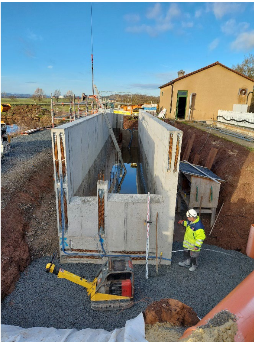
Blick in den 20m langen gefluteten Sandfang
