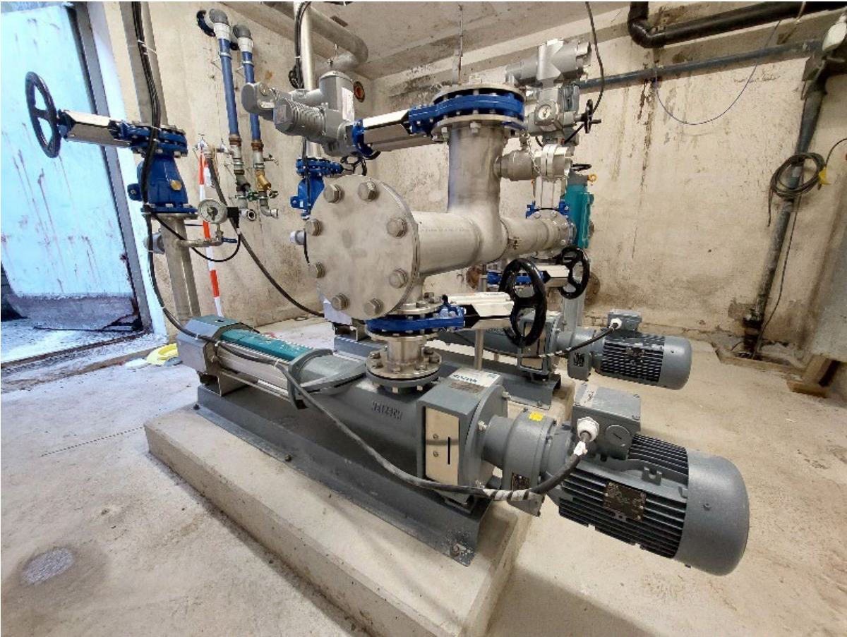
Im Pumpenraum: zwei neue Exzentrerschneckenpumpen, die den Schlamm in den Faulturm fördern
